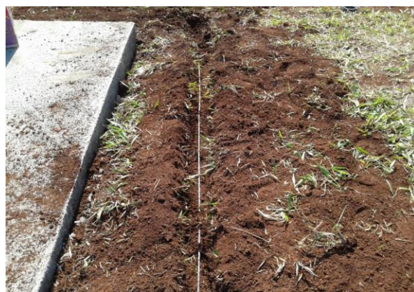
FOTO 50 MALHA ATERRAMENTO DO CONTAINER
