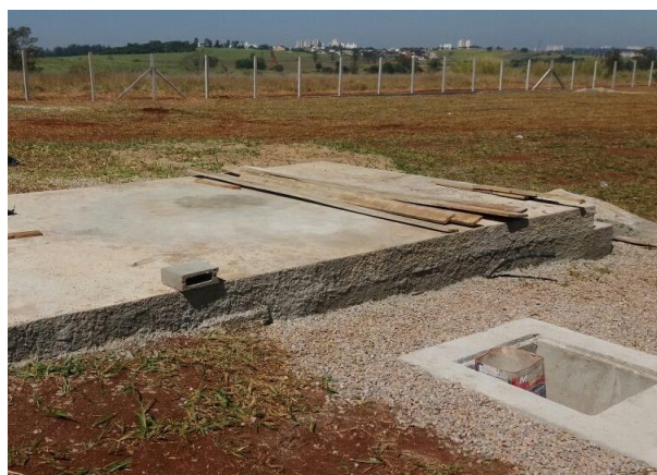
FOTO 52 BASE CONTAINER E CAIXA DE PASSAGEM
